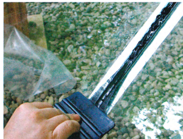
Nach dem Abziehen ermöglichte das Aufbringen eines Polyester-Klebbandes die Sichtkontrolle der Fugen während der Aushärtung.
